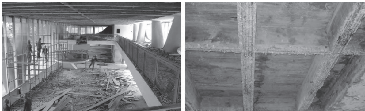
FIGURA 3 – Remoção de mesa inferior das estruturas de concreto armado para recuperação estrutural e tratamento de generalizadas infestações de cupins e problemas com umidade.
