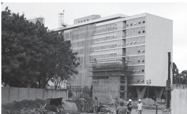
FIGURA 4 – Vista posterior do edifício do Palácio da Agricultura durante os trabalhos realizados de construção das escadas de emergência, transferidas para a fachada posterior do edifício.
